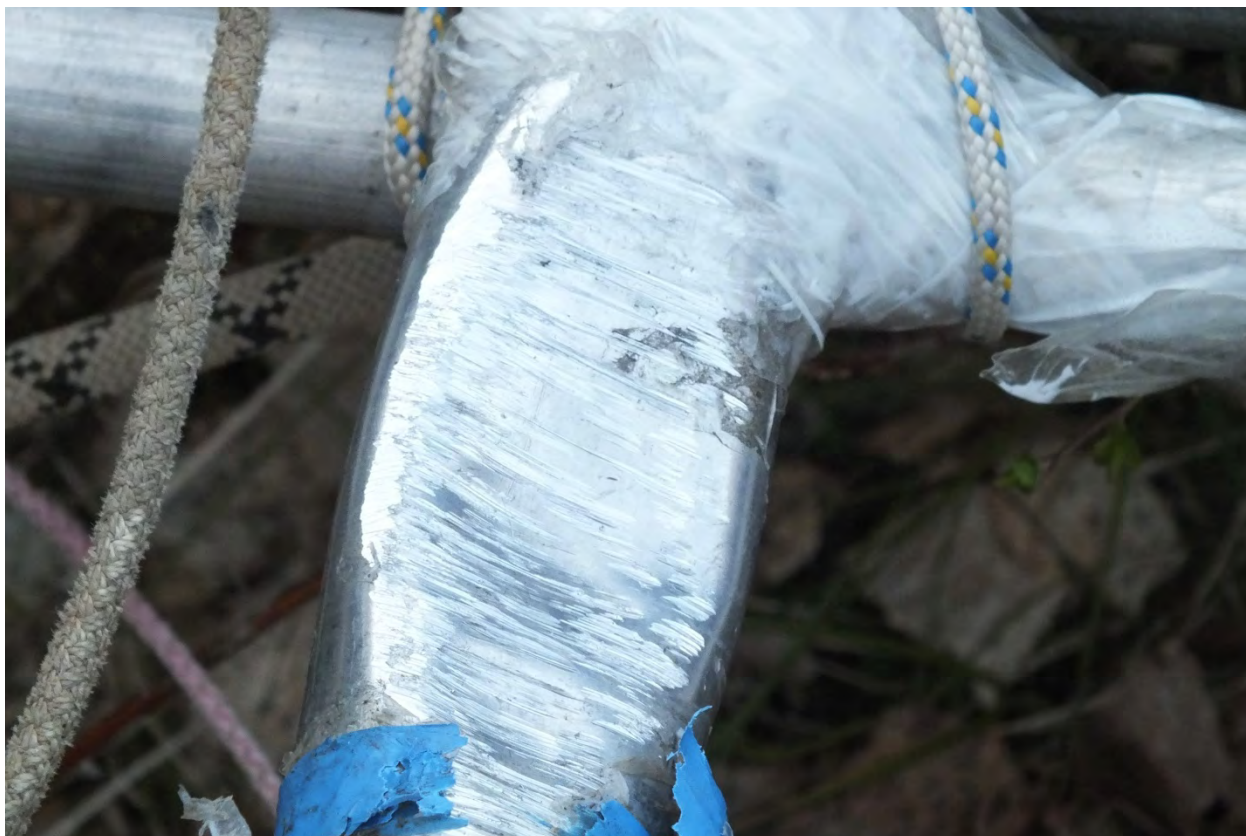
Фото 06.53. Две трубы сильно помяли. Вернемся домой - под замену
